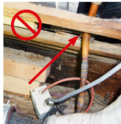
[ABB. 33] Holz in Kontakt mit heissen Rohrleitungen.
