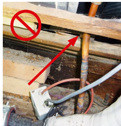
[ABB. 33] Holz in Kontakt mit heissen Rohrleitungen.
