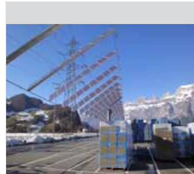
Une commande automatisée par ordinateur oriente les «Solar Wings» en permanence en fonction de la position du soleil.
