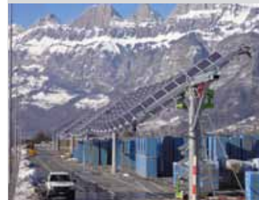
La construction à câbles porteurs de l'installation Solar-Wings peut recevoir 480 modules solaires.
